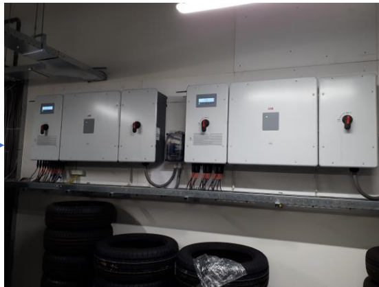
Omvormer naar wisselstroom
